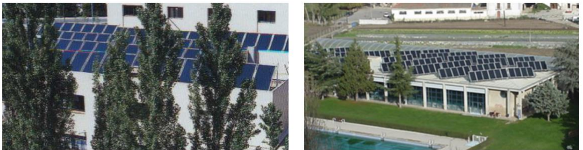
Figura 42: Instalaciones solares afectadas por sombras producidas por el crecimiento de árboles
