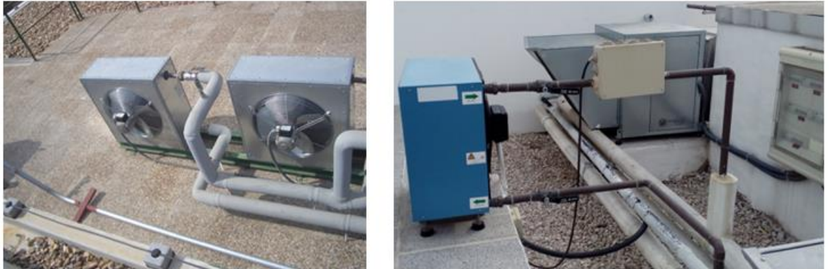
Figura 69: Ejemplos de aerotermos instalados para disipar calor
