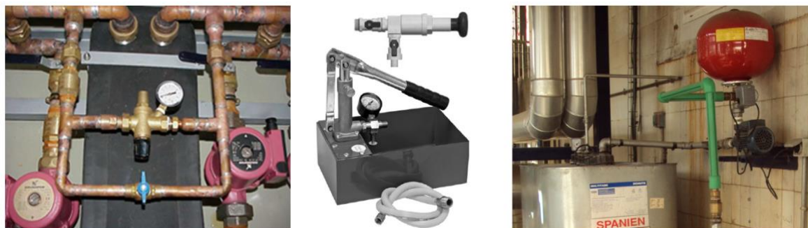
Figura 46: (Izq.) Circuito con alimentación automática de agua de red - (Cen.) Bombas manuales de llenado y presurización (Der.) Sistema de llenado constituido por depósito y grupo de presión
