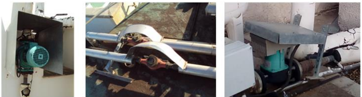
Figura 76: Ejemplos de defectuosa protección frente a condiciones exteriores
