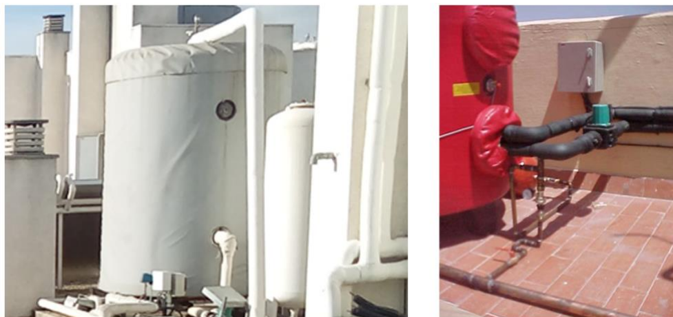
Figura 99: Ejemplos de defectuosa protección de acumuladores y componentes
