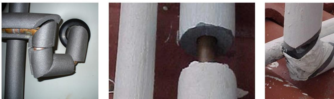
Figura 96: Ejemplos de aislamiento térmico mal instalado
