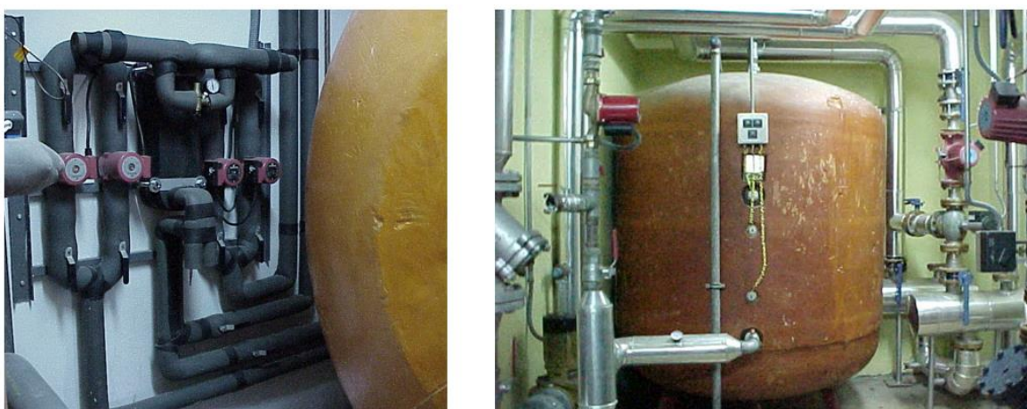
Figura 97: Ejemplo de accesorios de instalaciones aislados (izq.) y sin aislamiento térmico (der.)
