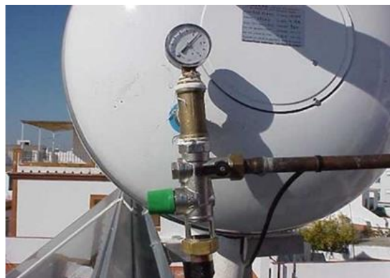
Figura 90: Ejemplo de manómetro instalado
