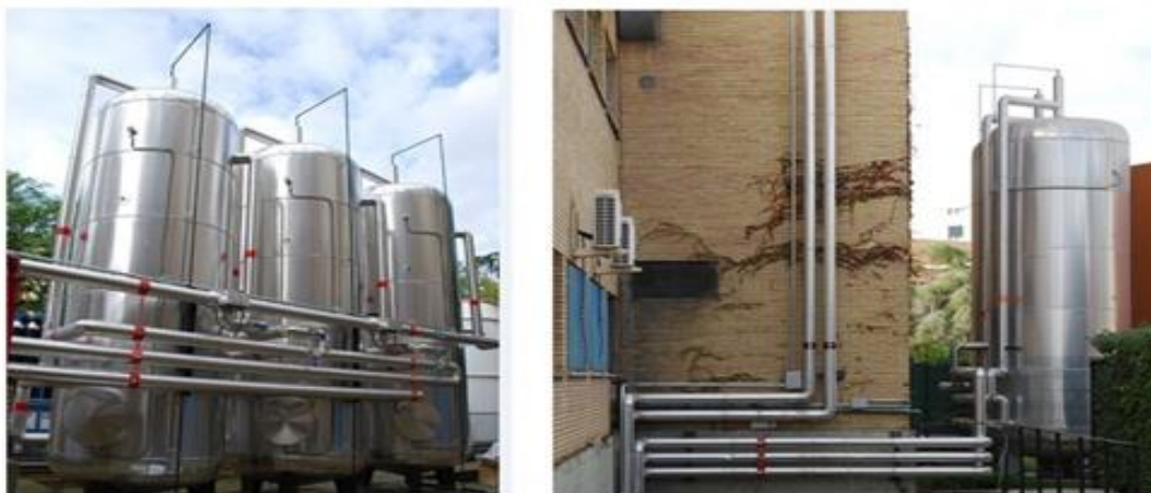
Figura 100. Ejemplos de correcta protección exterior de acumuladores y tuberías
