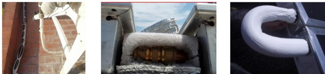
Figura 67: Ejemplos de aislamientos que no soportan altas temperaturas
