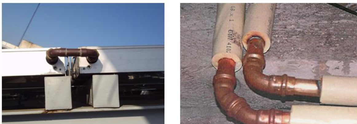
Figura 95: Ejemplos de tramos de tuberías sin aislamiento
