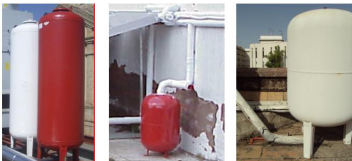
Figura 89: Ejemplo de vasos de expansión instalados al exterior y conectados al circuito primario mediante ramal con aislamiento térmico que afecta negativamente a su durabilidad
