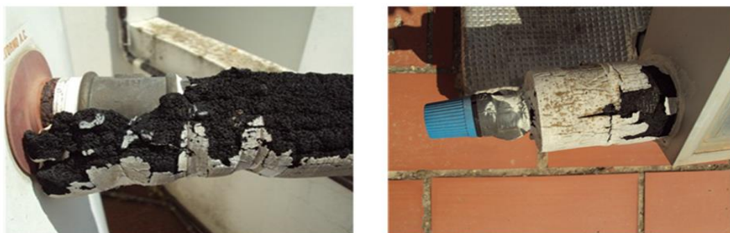
Figura 101: Ejemplo de mala calidad de la protección y deterioro del aislamiento
