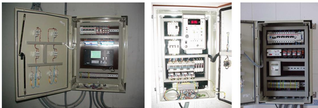
Figura 93: Ejemplos de cuadros eléctricos completos incluido sistema de control y de monitorización
