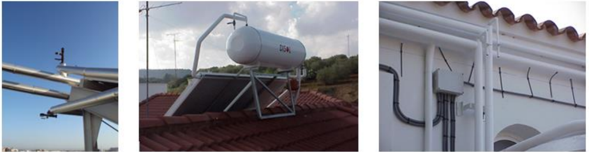
Figura 79: Ejemplos de purgadores manuales difícilmente accesibles
