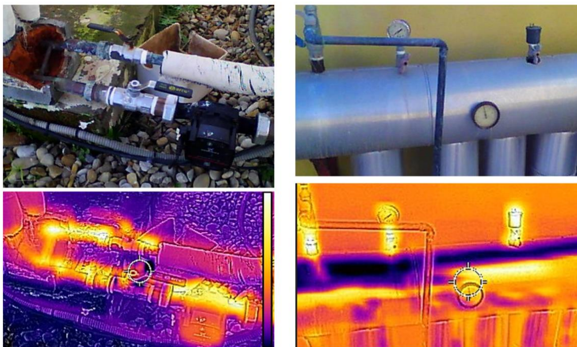
Figura 51: Ejemplos de termografías de instalaciones
