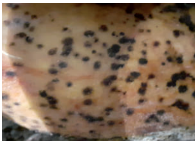
Imagen 17c. Manchas negras producidas por mohos.
