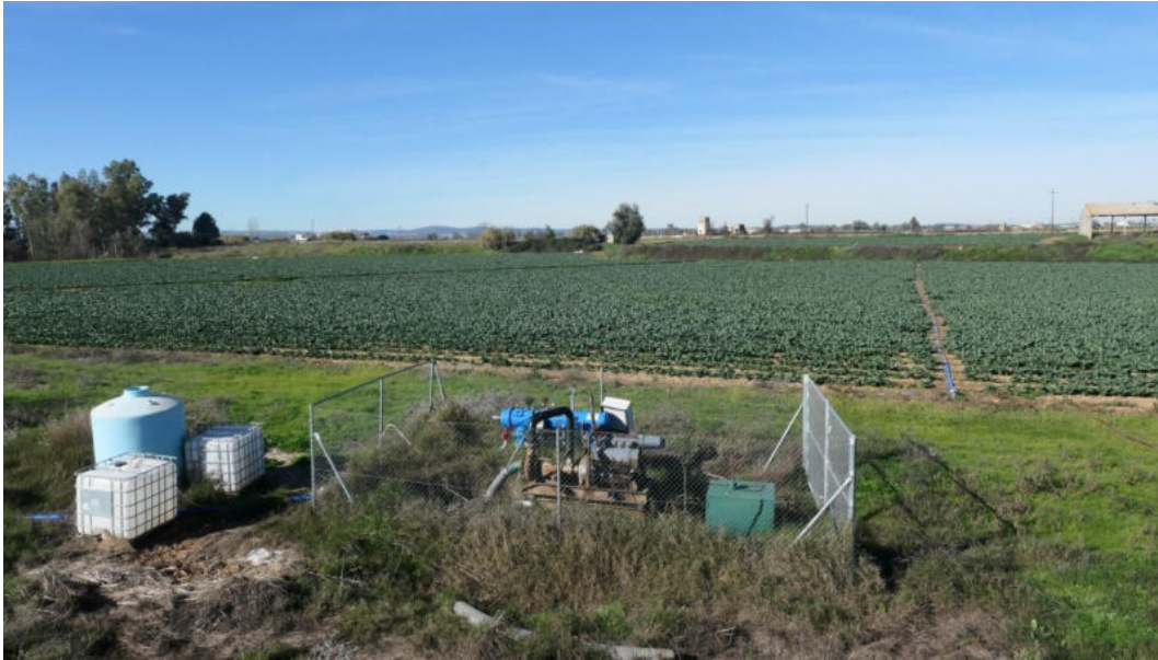
Equipo de riego por goteo
