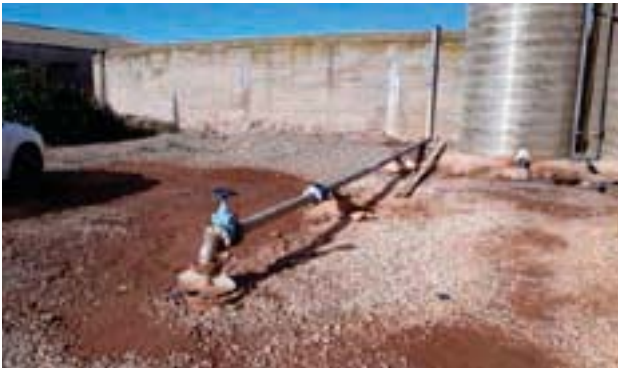
Fotografías ilustrativas de los contadores instalados en aprovechamientos visitados.
