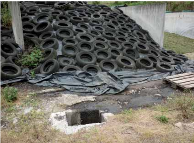
IX.1.- Fosa construida a pie de ensilado para captación de efluentes
