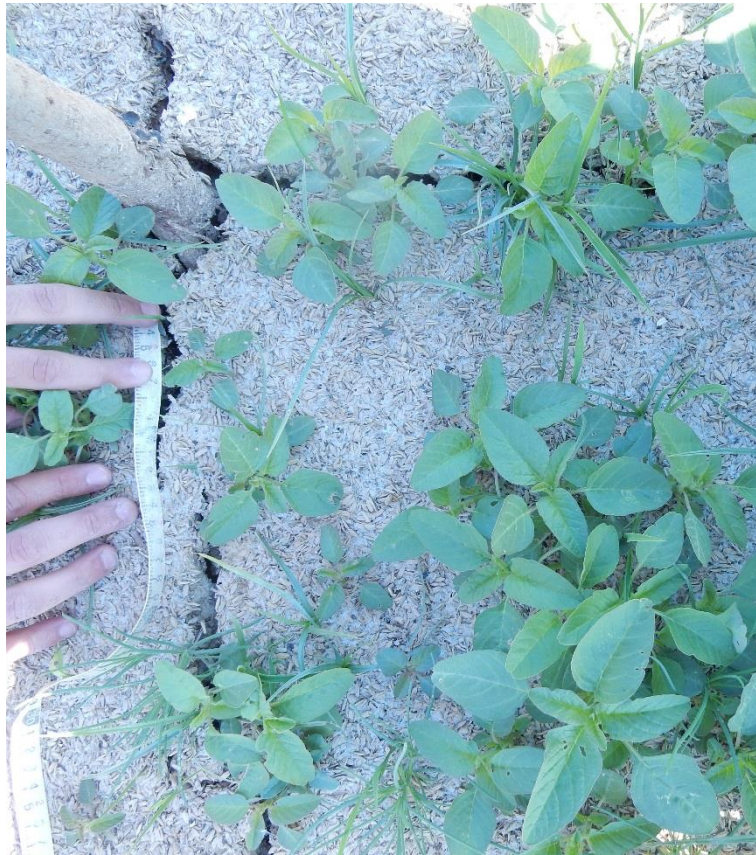
Imagen 17: Medida de las grietas en el hidromulch
