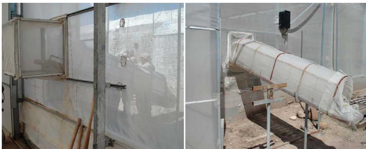
Algunos sistemas, como los de estas imágenes, evitan tener las puertas abiertas durante la retirada de las producciones.
